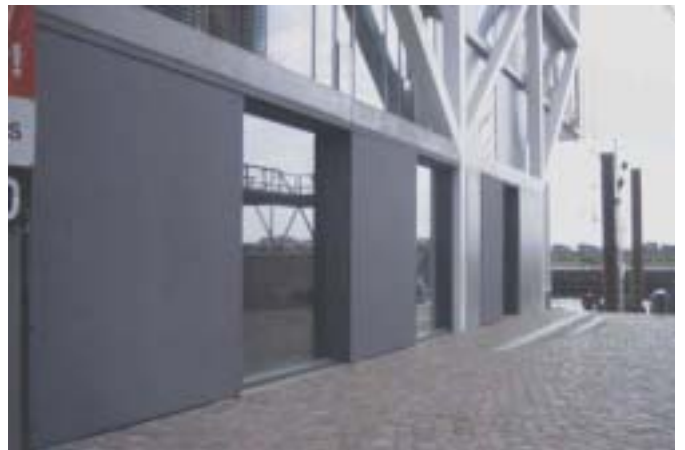
Objektschutz: Flutschutz Tore im Sockelgeschoss – Object protection: Flood gates in the basement
